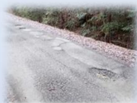
舗装の穴ぼこ・陥没
